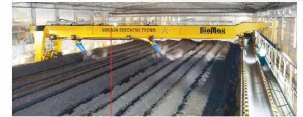
Detalhe da Ponte Rolante
